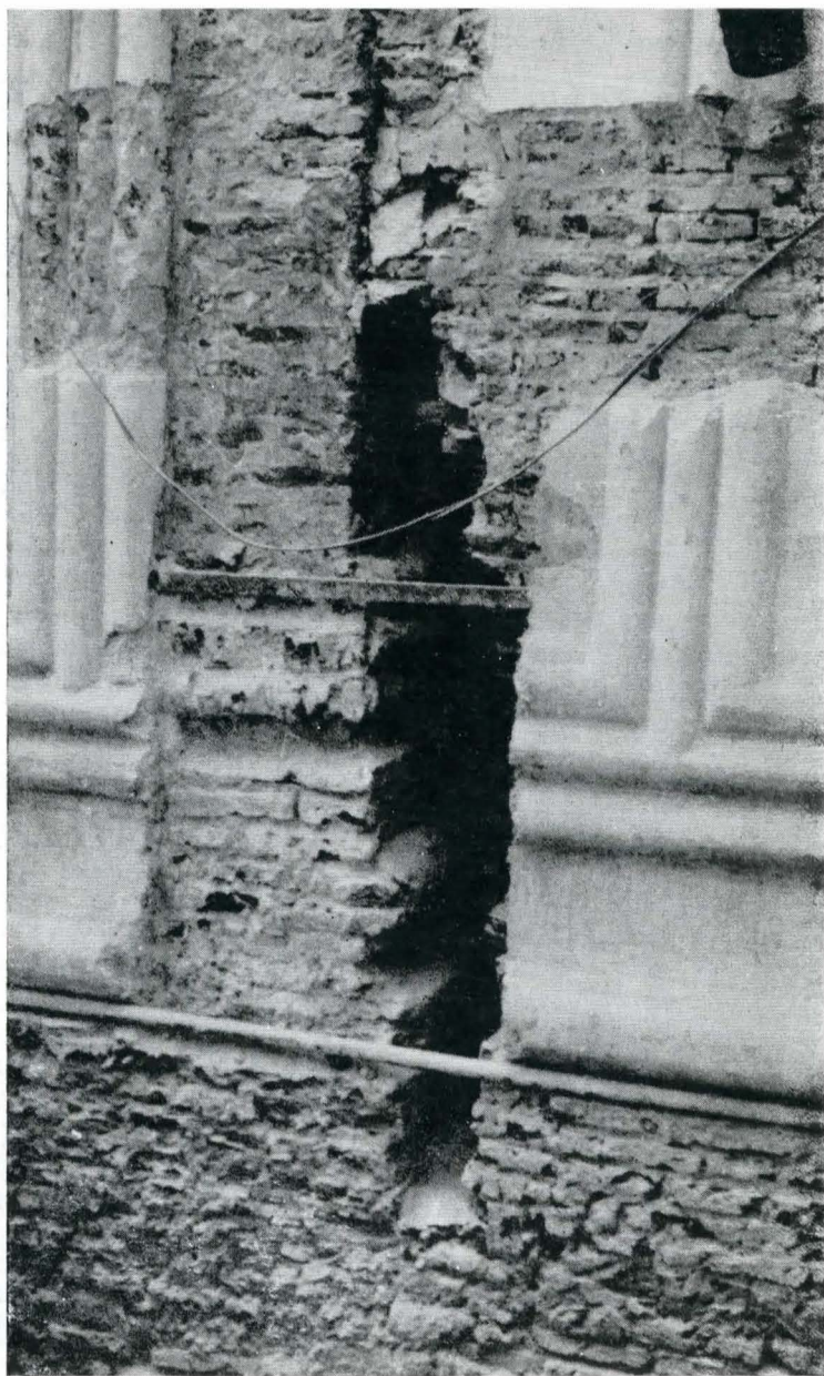
Fig. 5. Decalarea ciubucelor față de urmele originare.
