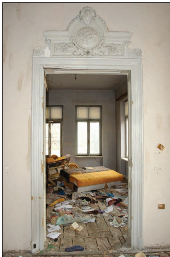
Fig 16 - Imobilul din strada Berzei numărul 89 – ancadrament de ușă la etaj – în data de 17 februarie 2011
